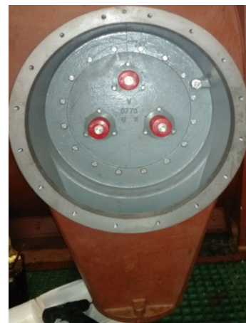
高压接线盒内部
