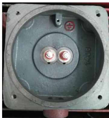
加热器接线盒内部
