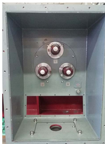
主接线盒内部
